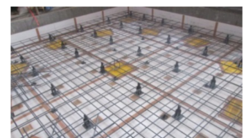
機械式駐車場
